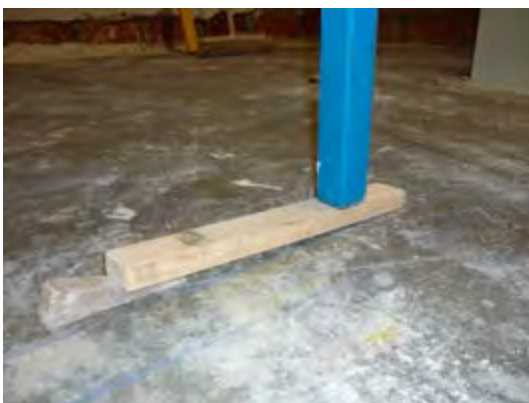
Placement d'un étançon avec latte de serrage au sol Photo: J. De Schepper
