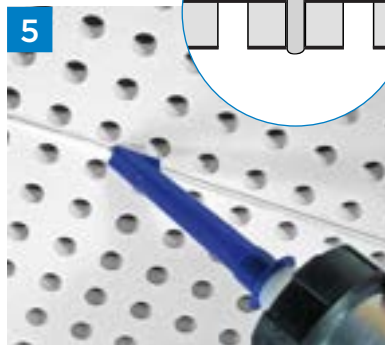
5 Comblez les joints sur toute leur profondeur. Veillez toujours à une protubérance à l'arrière de la plaque
